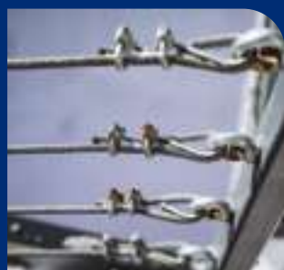
Cables y retenidas
